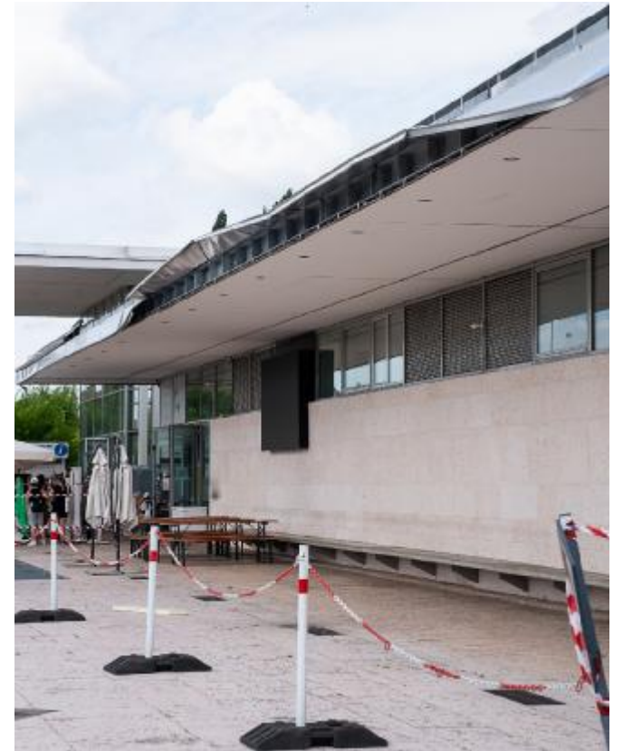
Tetti Effetti della bufera sulla copertura del parcheggio Centro
